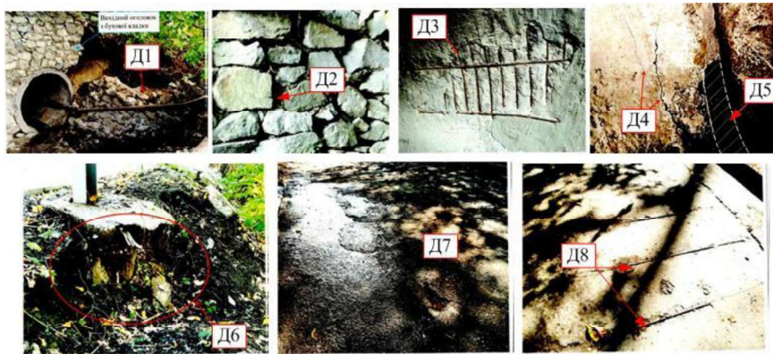
Рис. 1. Дефекти та пошкодження конструктивних елементів
